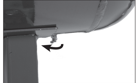
Figura 10 - Drenaje manual del tanque
