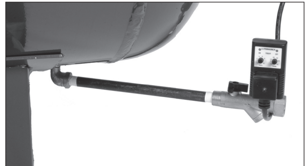
Figure 12 - Drenaje automático del tanque
